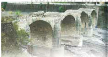
圖20 北港溪糯米橋，圖片來源：于炳盛、曹永德、王玉瑞著，《臺灣的橋樑》，頁154。
