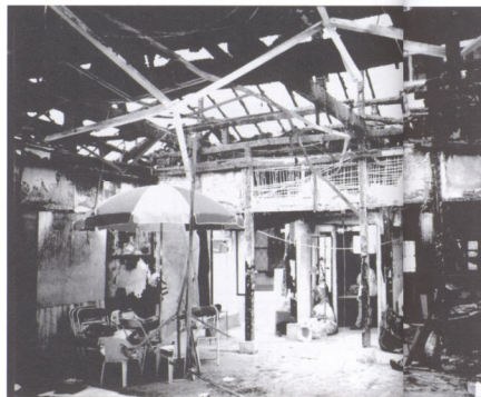
圖20 火災水損後的第一舞蹈教室
