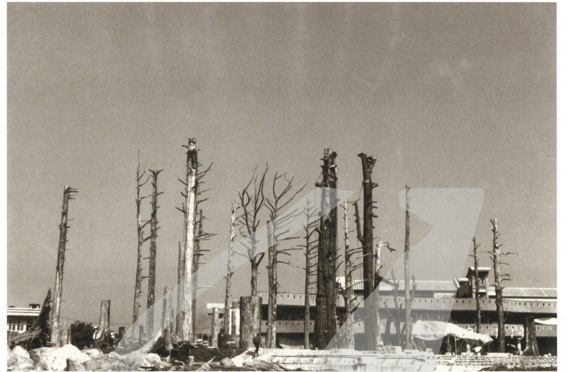
一九九七年宜蘭縣府廣場「協力擎天」景觀規劃工程施工情形。
